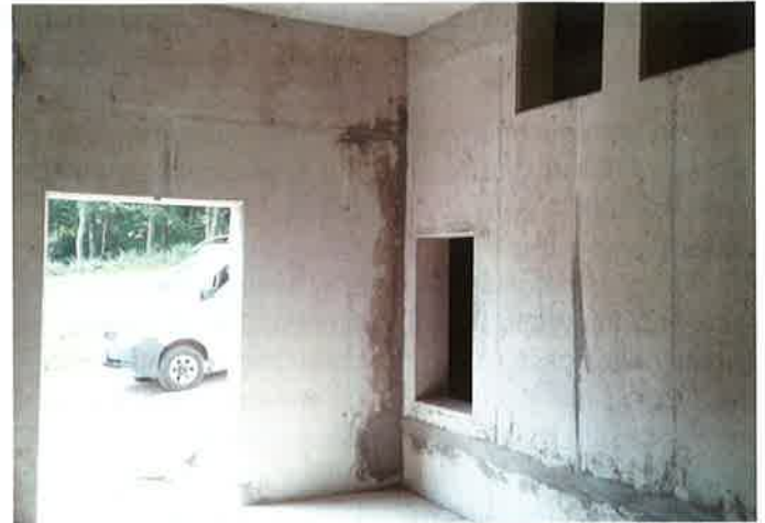
Bild aus der Schieberkammer (Technikraum) des Hochbehälters. Die kleine Öffnung neben dem Eingang ist für die Druck-Eingangstür zum Behälter.
