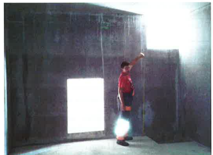
Bild aus einem der beiden 60 m³ Behälter. In die Öffnung rechts oben kommt ein Fenster für die Sichtkontrolle hinein. Bis knapp unter dieses Fenster wird der Behälter gefüllt. In die Öffnung links unten kommt eine Drucktür aus Edelstahl. Über diese erfolgt der Zugang zum Wartungszwecken.
