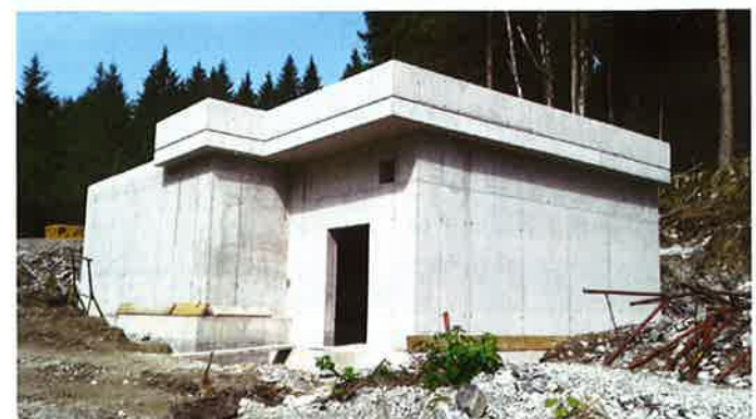
Der Behälter wird nahezu vollständig, bis auf den Eingangs-bereich, eingeschüttet. Im Technikraum wird auch eine UV-Desinfektion zur Entkeimung des Wassers eingebaut.
